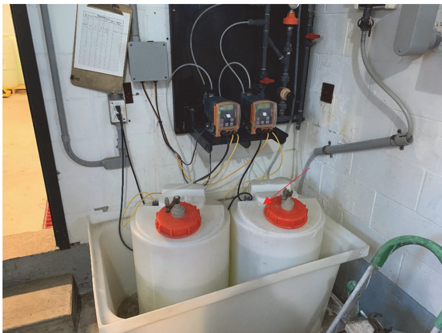
29. Système de dosage de l'hypochlorite de sodium – 2024-11-08
