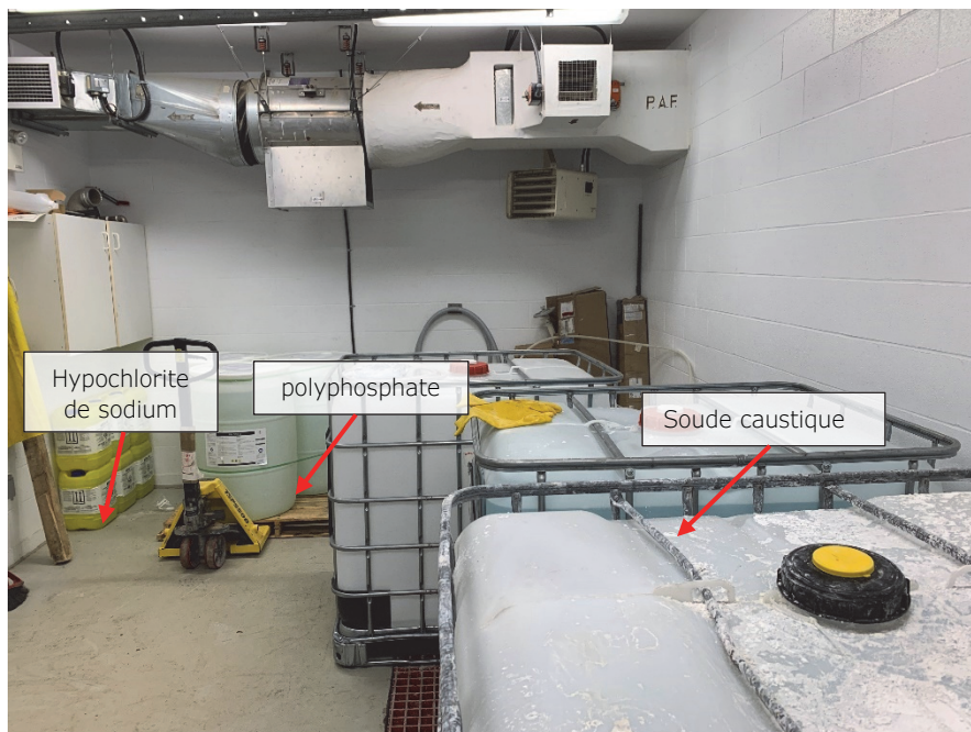
32. Chambre d'entreposage des produits chimiques liés au traitement de l'eau brute des puits PE-5 et PE-6 – 2024-11-08
