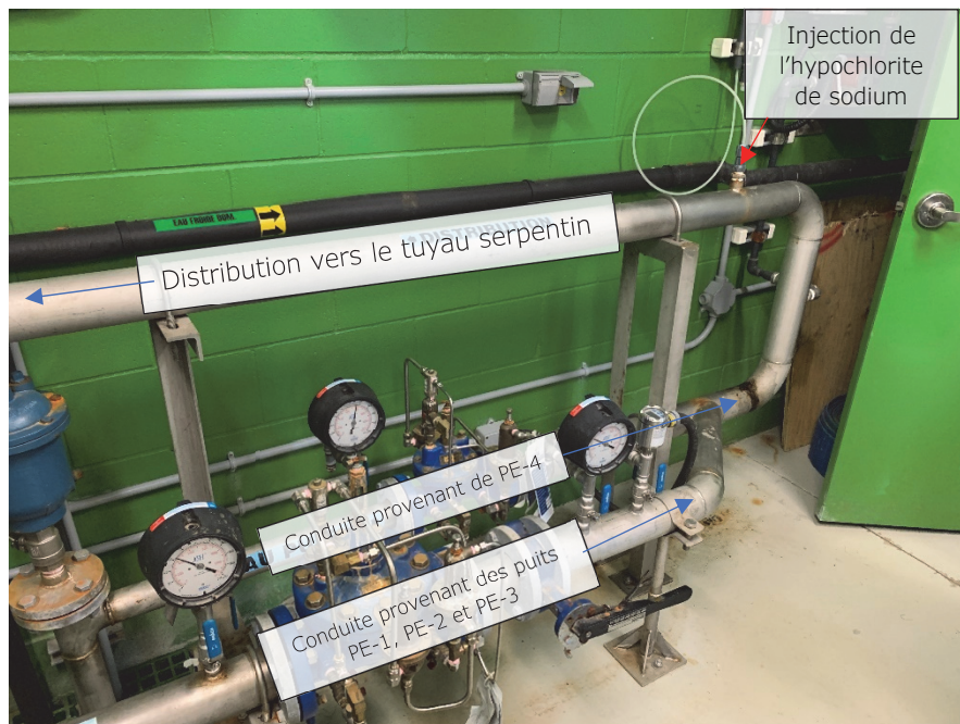
17. Vue de la jonction des tuyaux provenant des puits PE-1,-2,-3 et -4 ainsi que le point d'injection de l'hypochlorite de sodium – 2024-11-08
