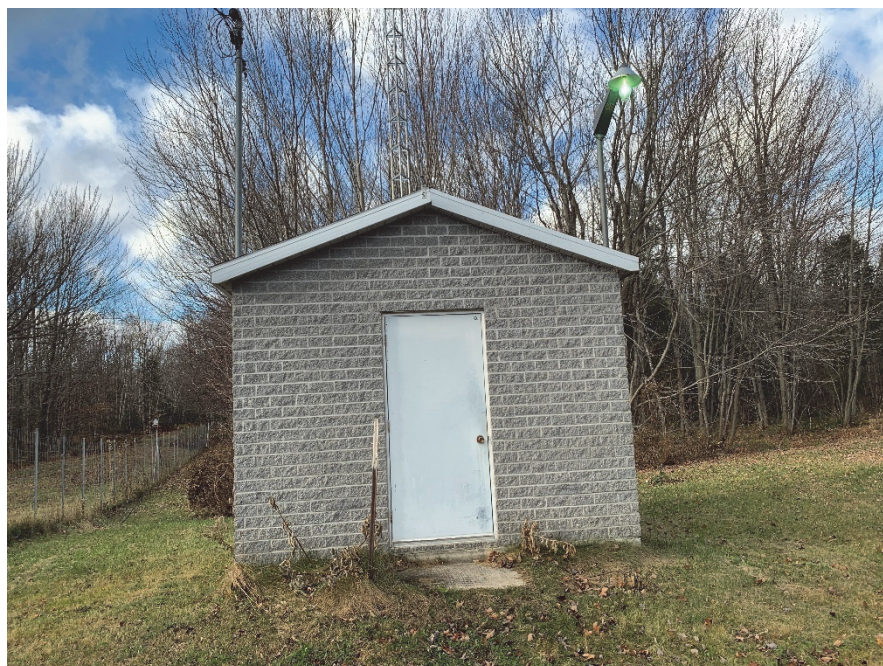
10. Vue extérieure de la station de pompage des puits PE-1, PE-2 et PE-3 – 2024-11-08
