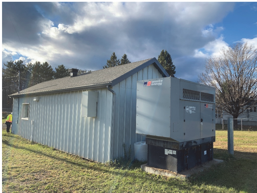
25. Station de pompage et traitement des puits PE-5 et PE-6 ainsi que la génératrice associée au site – 2024-11-08
