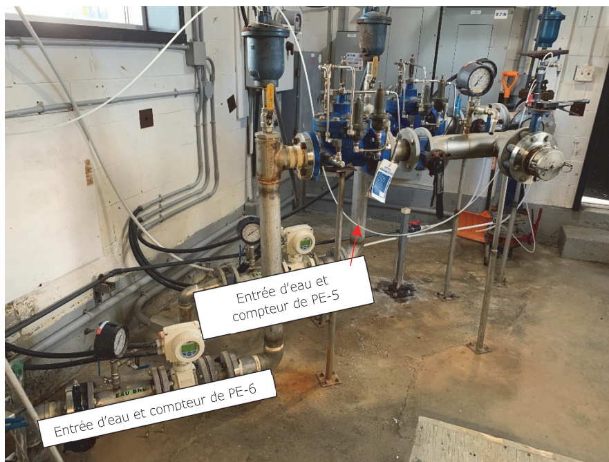
26. Vue de l'intérieur de la station de pompage et traitement, entrées d'eau des puits PE-5 et PE-6 – 2024-11-08
