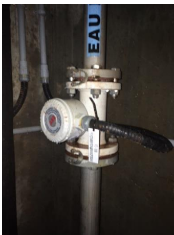
Figure 2. Débitmètre du puits 4
