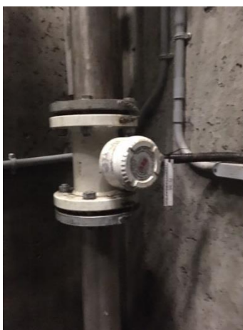
Figure 1. Débitmètre du puits 1-2-3.
