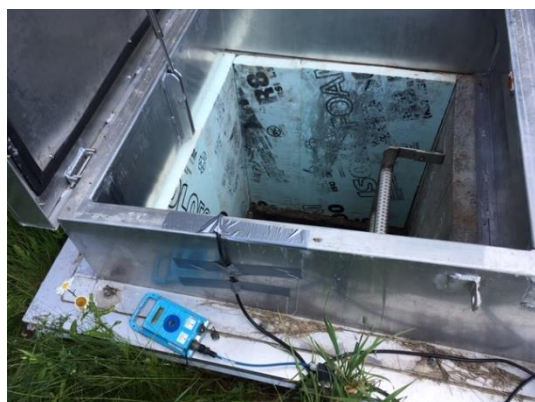
Figure 10. Installation de l'équipement étalon pour la vérification du débitmètre de distribution
